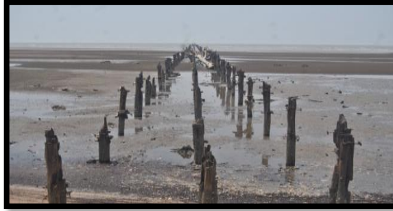
Gambar 1 : Kondisi jembatan kapal yang rusak parah
